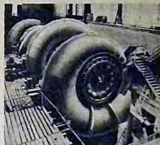
Montaggio di una turbina a chiacchiera di 29500 HP con una pendenza (caduta utile) di m. 58.
